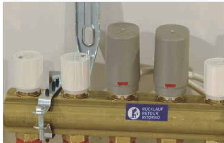
Рисунок 9. Электротермические сервоприводы, установленные на коллектор.
