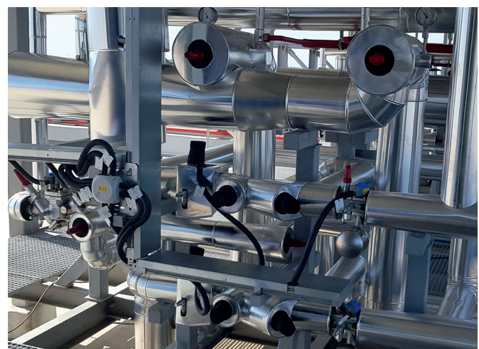
Рис. 2. Распределительное обвязки испарителя в теплоизоляции
