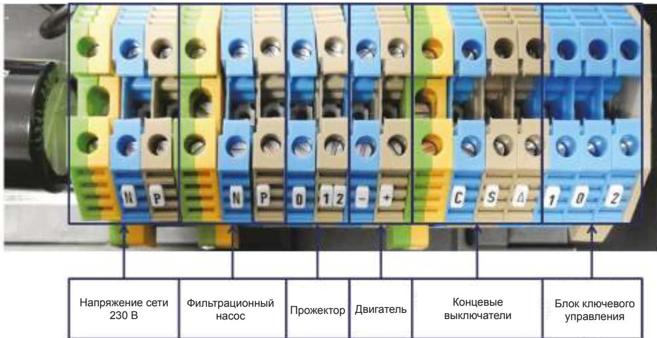
Figure 55 – Электрический щит бассейна PISCINE URBAINE
